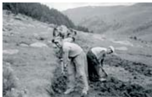
Construcció de la carretera de Grau Roig, l'estiu del 1956. Va ser un camí de terra fins l'any 1983.
